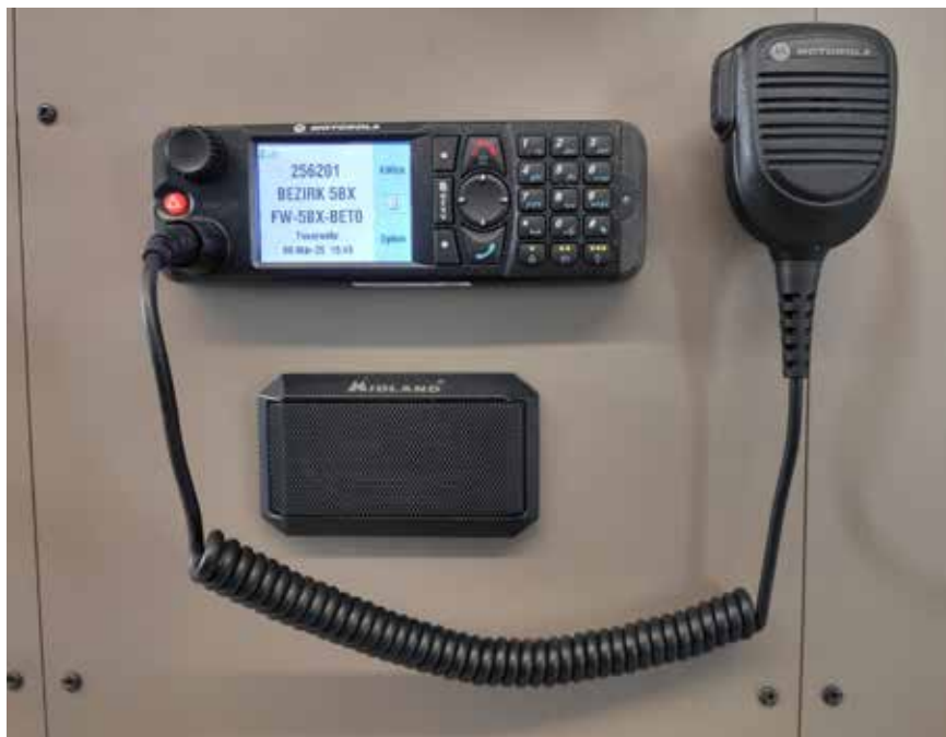
Neue Funkgeräte für die Feuerwehren
